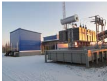
ETD «Transformatory a.s.»
