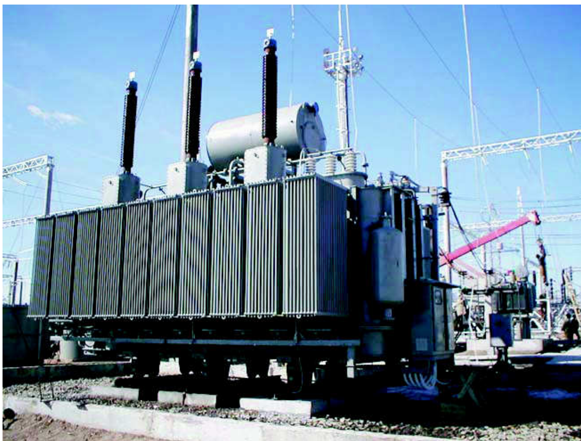
Рис. 1. Шунтирующий реактор, управляемый подмагничиванием, типа РТУ-100000/220 на подстанции «Чита»
