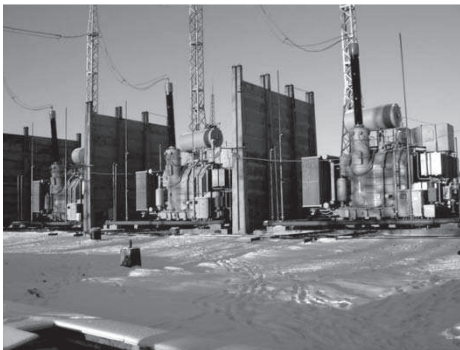
Рис. 1. Внешний вид реактора РТУ-180000/500 — трехфазной группы реакторов РОДУ-60000/500 на подстанции «Таврическая»
