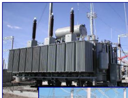
УШР-100/220 + БСК 10 (БСК 220 ) ПС «Чита» (ПС «Озёрная»)
