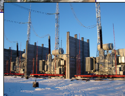
УШР-180/500 + БСК 35 ПС «Таврическая» ПС «Барабинская»
