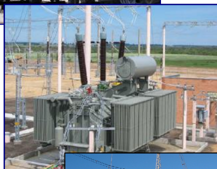
УШР-180/330 + БСК 10 ПС «Барановичи» ПС «Игналинская»
