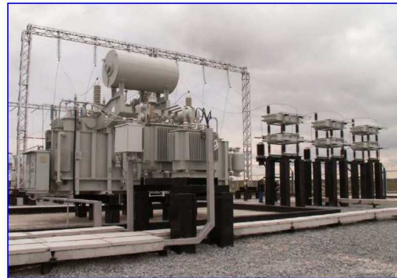
ИРМ-110/25/25 на ПС «Звездная» (ПС «Сугмутская-2»), РФ 2007г.
